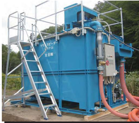
小型濁水処理装置
